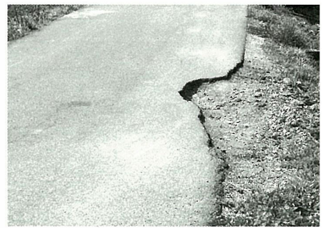
路肩の崩れた町道
