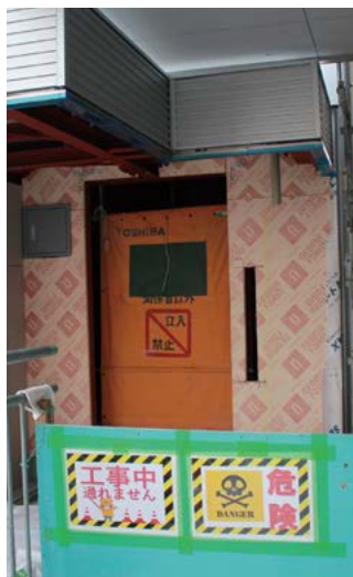
エレベーター出入口
