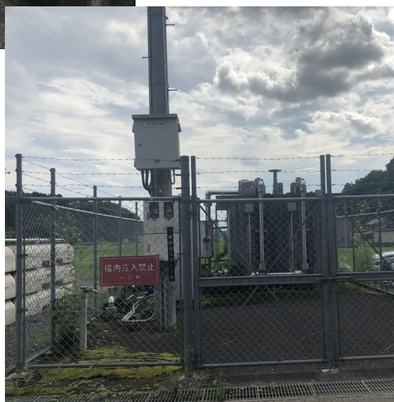
下飯田加圧ポンプ所
