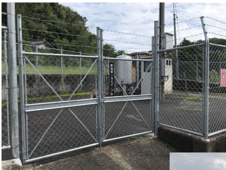
鹿塩第2加圧ポンプ所
